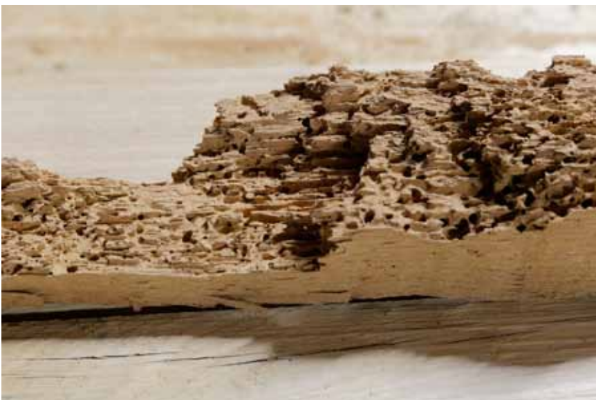
Teil eines maroden Balkens, der erneuert werden muss.
