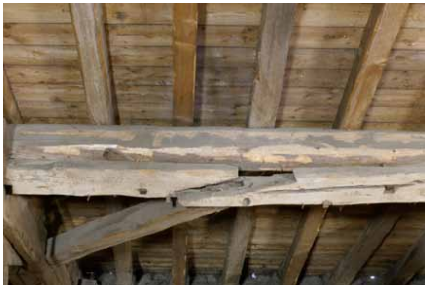
Ein geschädigter Balken des Daches.
